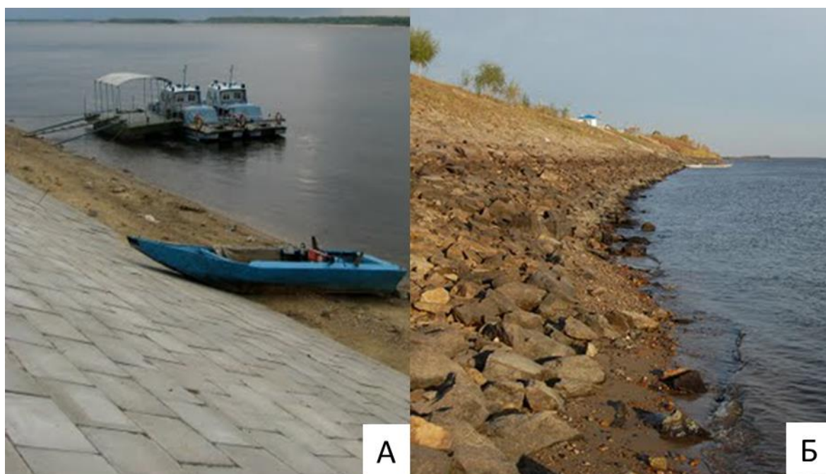
Рисунок 92. Укрепление правого (китайского) берега в среднем течении Амура от размыва: А. бетонное укрепление; Б. каменная насыпь (фото Е.К. Губаревой)
